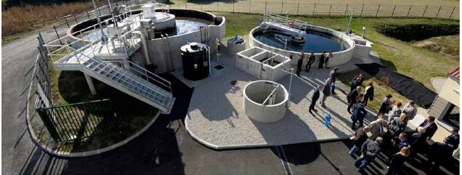
La nouvelle station d'épuration d'Hermonville doit permettre de répondre à la croissance démographique de la commune. Bernard Sivada
